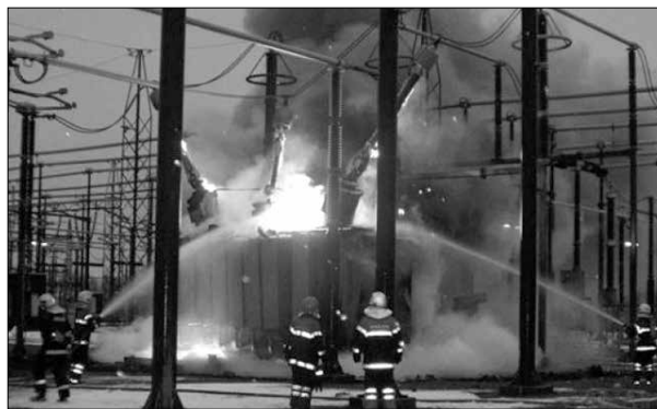
شکل یک- آتش سوزی ترانسفورماتور قدرت
